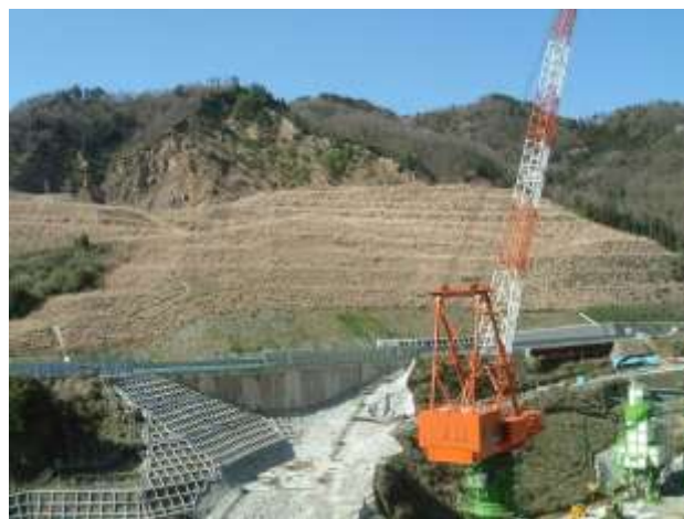
苗木植栽前の採石場跡法面 播種工が行われたがススキ群落となっていた
